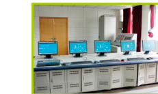
互联网+DCS实训室
