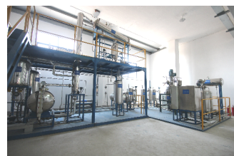
萃取单元实训室
