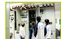
智能电网输变电实训室
